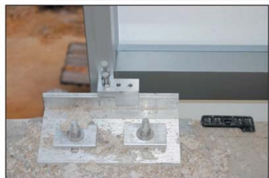
مهار یکی از قطعات نما به سازه بوسیله بست های بار ثقلی
