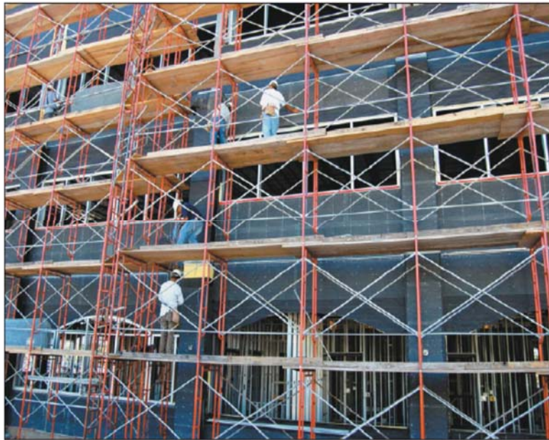
شکل ۳-۶- نمای یک ساختمان ۵ طبقه پوشانده شده با استفاده از داربست به منظور اجرای نمای سیمانی
